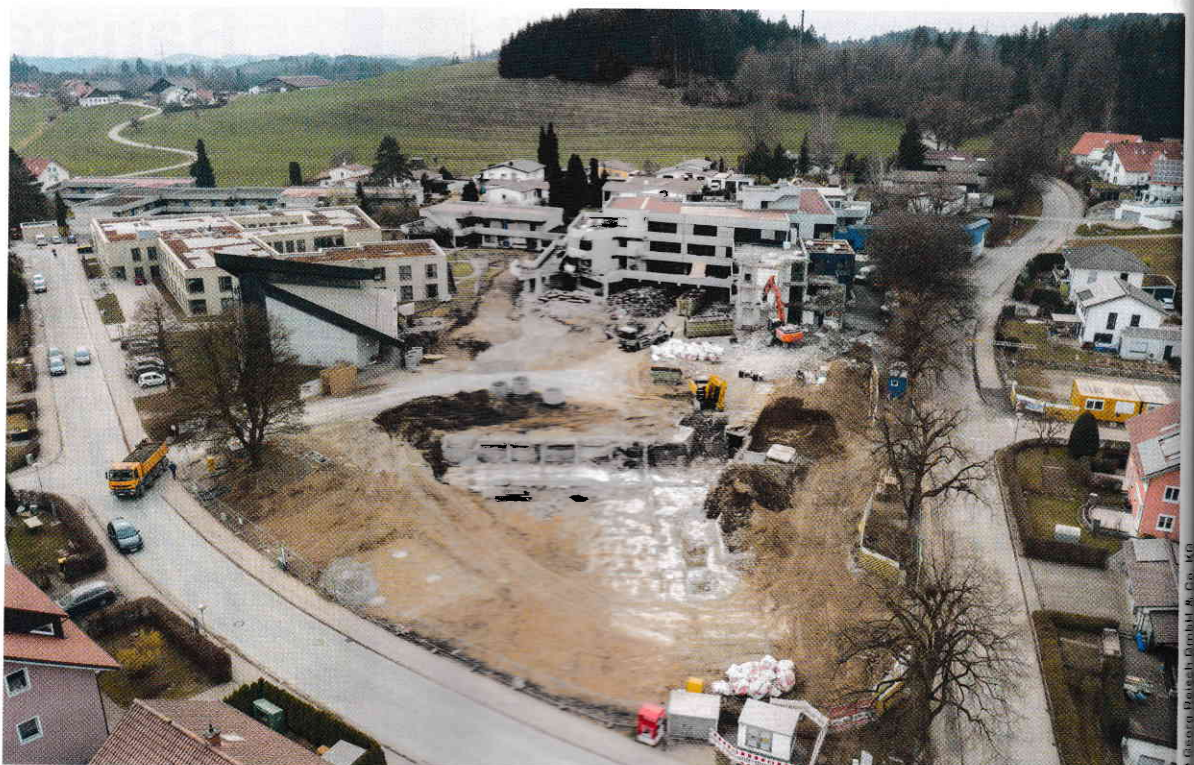
Das frühere Seniorenzentrum von St. Vinzenz wurde abgerissen. Rund 15.000 Tonnen Betonbruch wurden wiederverwendet.
